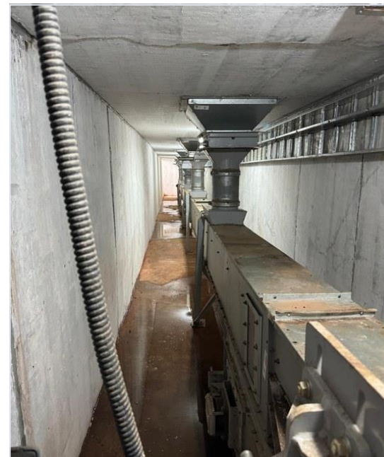
Túnel com redlers reduz movimentação de pó
