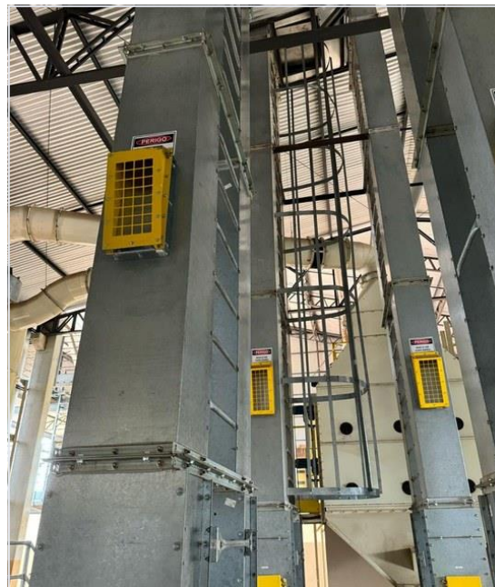
Válvula de alívio de explosão no elevador
