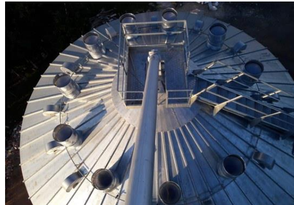
Exaustores instalados na cobertura
