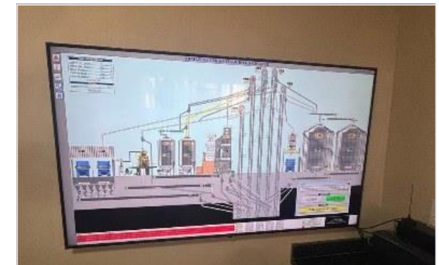
Supervisório espelhado na sala de operação
