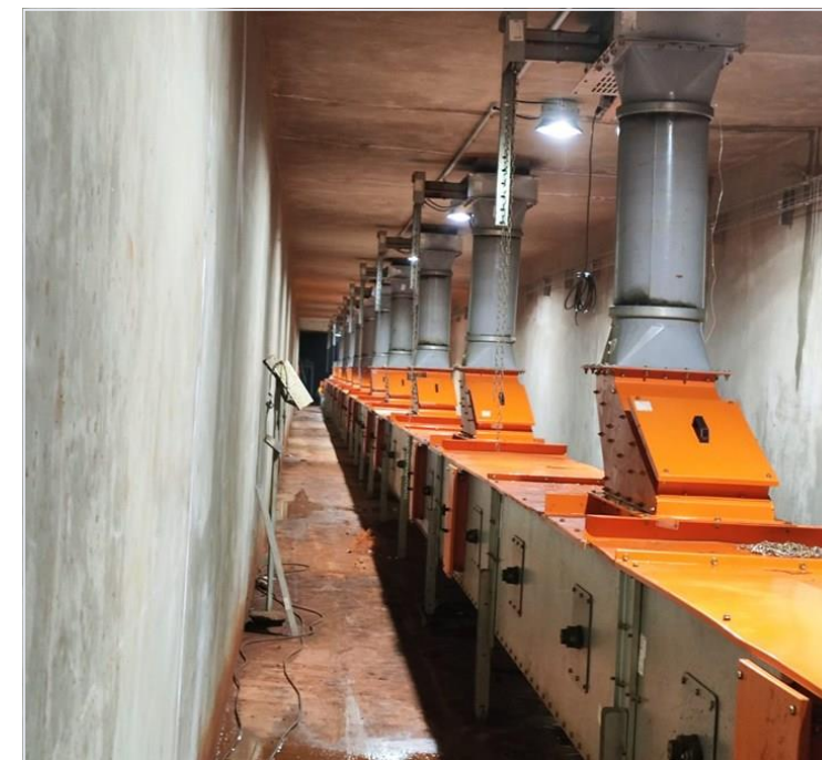
Redlers em túnel
