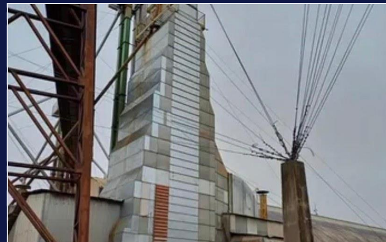
Unidade antiga — secador antigo = maior risco de incêndio — ano 1998
