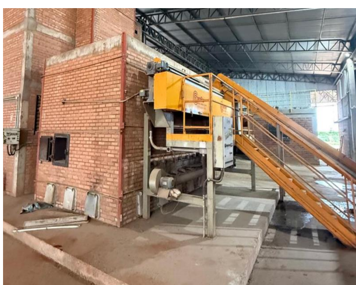
Cavaqueira automatizada da fornalha
