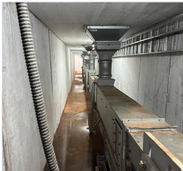
Redlers no túnel
